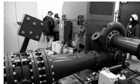
【村山六ヶ村堰発電所の内部】
