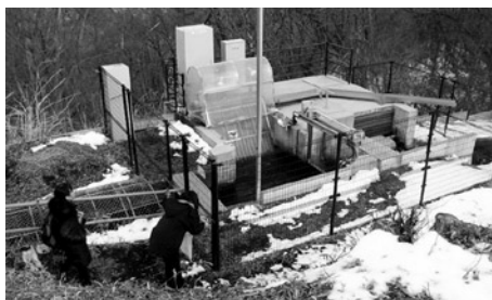
【小水力発電の取水口】
