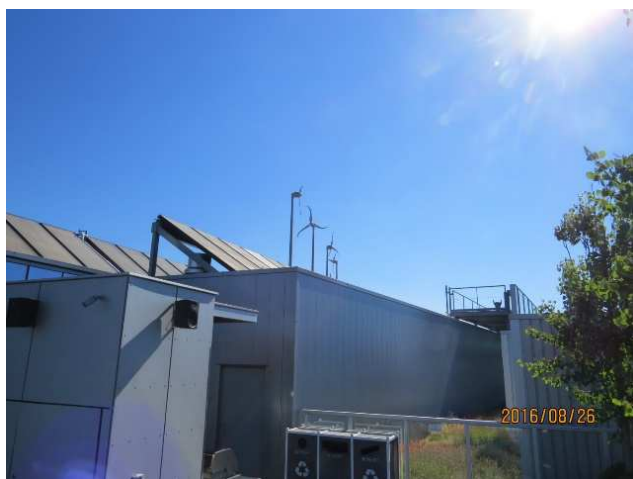
屋上の太陽熱温水器(左手前)
