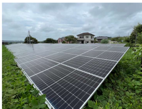
EGP 千葉県高滝発電所
